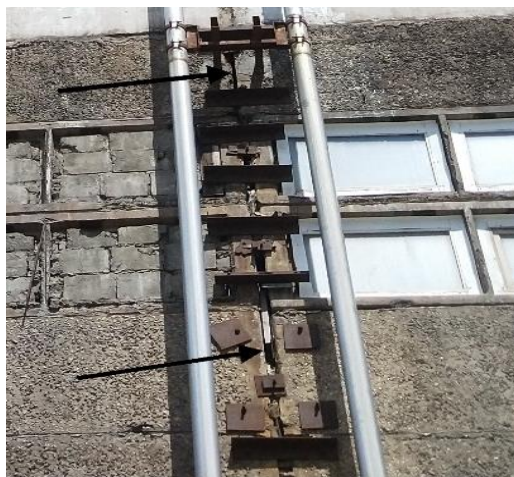
Рис.3. Раскрытие вертикального шва по ряду Б/1/85
