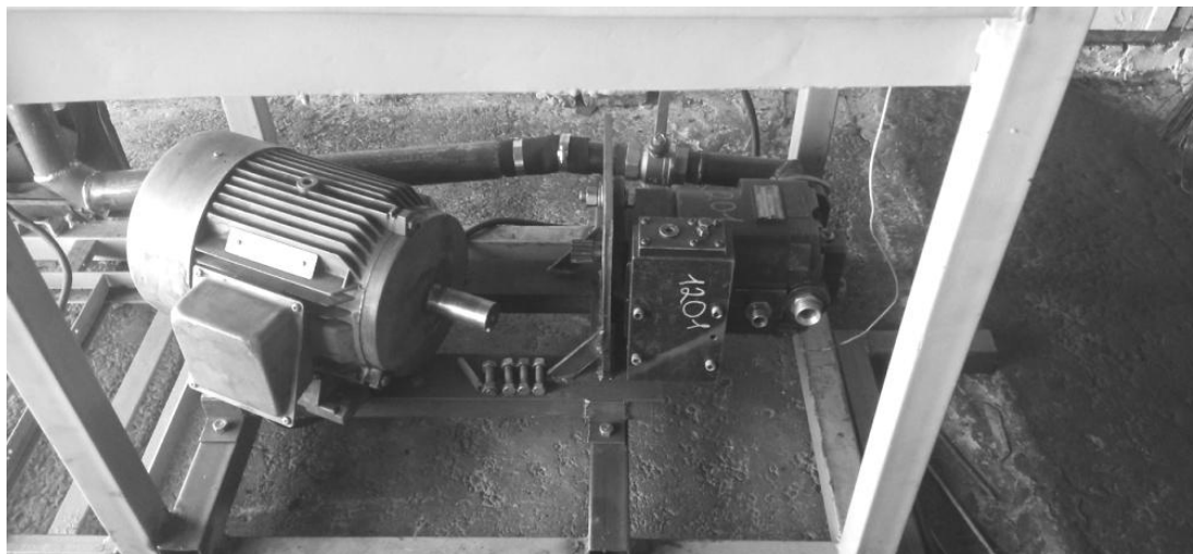
Рис.4. Изображение проектирующегося стенда для проверки гидромоторов на базе электродвигателя мощностью 11 кВт в условиях предприятия ООО «Адамант»
