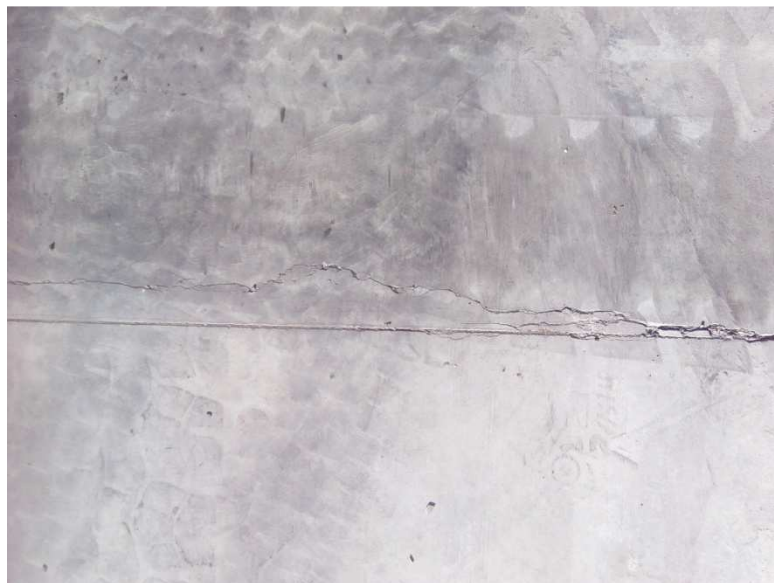
Рис.3. Дефект температурной деформации
